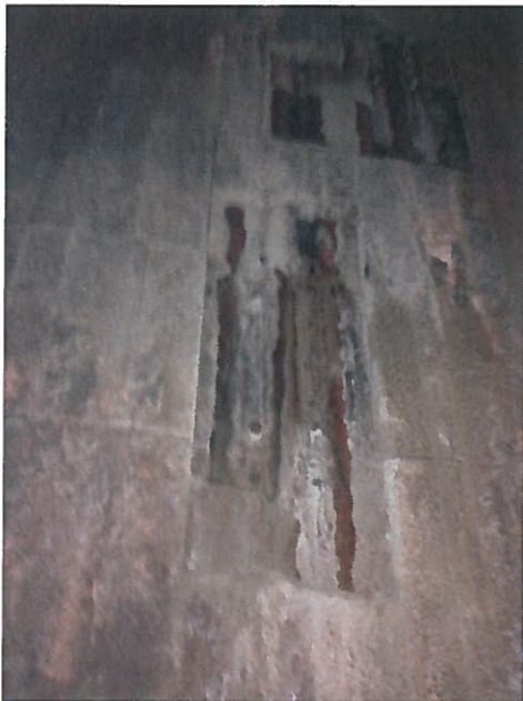
Figuur 9 meerdere verwijderde tegels, met corrosie erachter. Betonvulling is niet voldoende.
