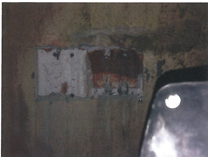
Figuur 7 ontbrekende tegels, waaronder bij één wel en bij één geen beton zat.
