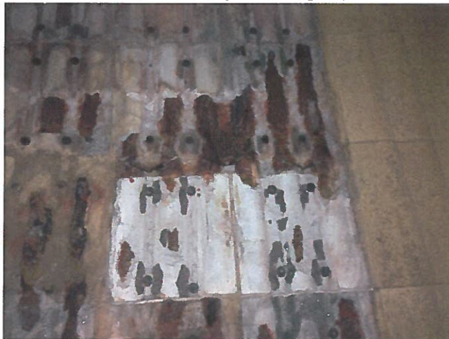
Figuur 10 Verwijderde tegels. Veel ankers zijn rood verroest en dat hoort niet, want het rookgas hoort geen contact met de ankers te maken. Verder is de betonvulling overduidelijk niet uniform geweest. Overal waar er geen bedekking was van de wand is deze rood gecorrodeerd.
