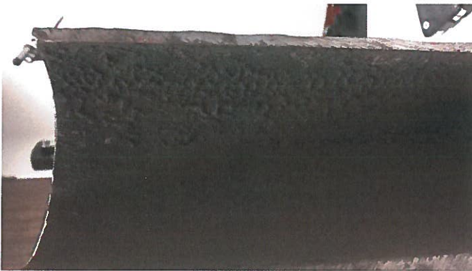
Figuur 11 Sediment in ketelpijp (linkerwand overgang tweede naar derde trek)
