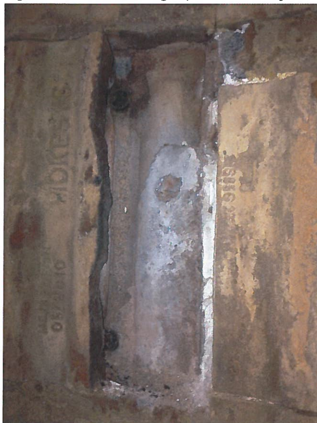
Figuur 8 gebroken tegel. Anker afgebroken en sterk gecorrodeerd. Er lijkt rookgasindringing door de voeg boven te zijn geweest. Betonvulling is niet uniform; bovenin was er geen goede hechting, onderin het rechterdeel wel.
